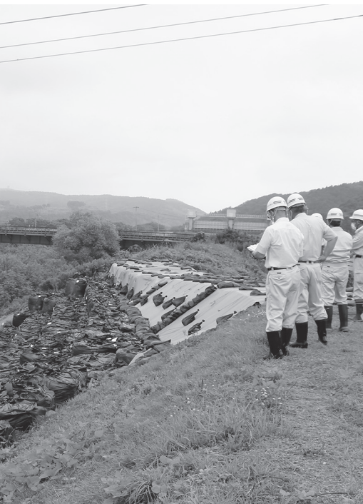
決壊した出来川鳥谷坂付近の堤防
