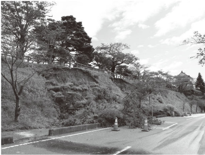
台風19号直後の城山公園前
