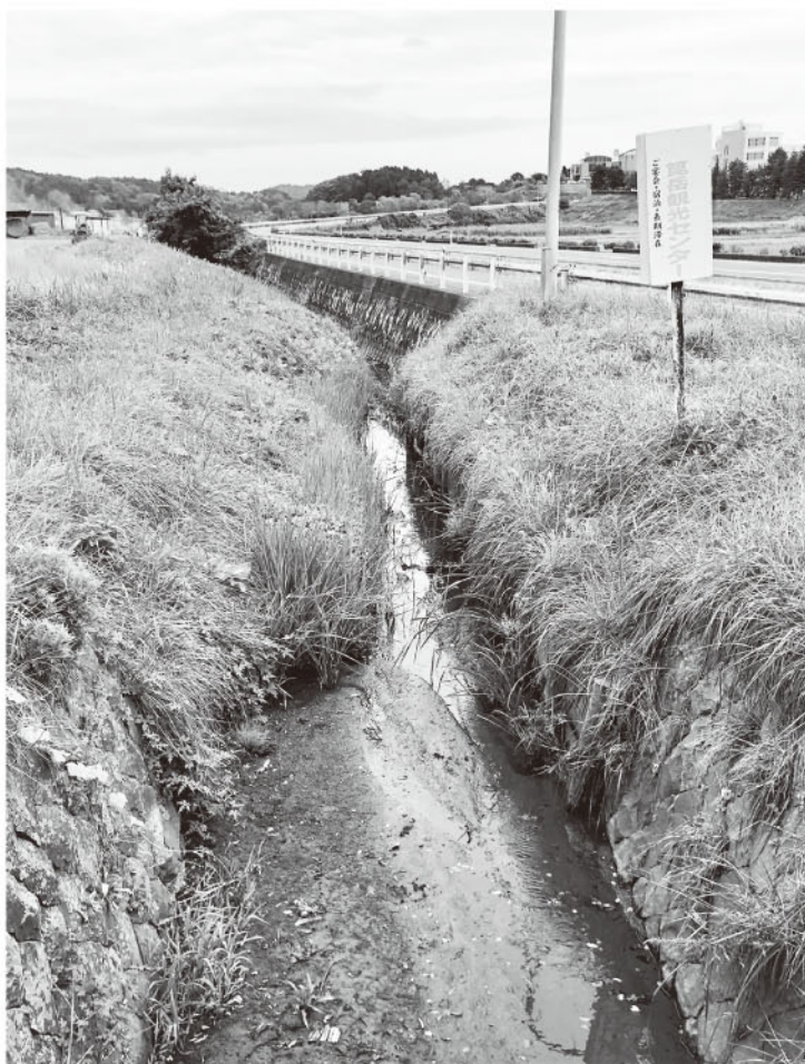
改修が急がれる中江排水路上流部
