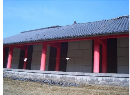
東日本大震災による 天平ろまん館の瓦屋根落下
