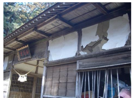
東日本大震災による 妙見宮長床の土壁落下
