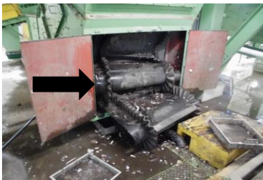
焼損・脱落したベルト
